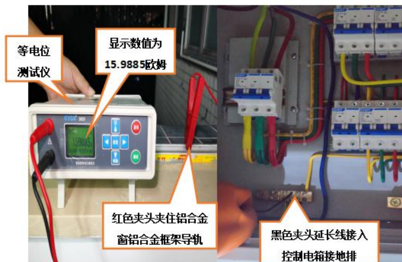
图 16 铝合金窗框架导轨与接线板专用开关控制电箱等电位情况勘查图
