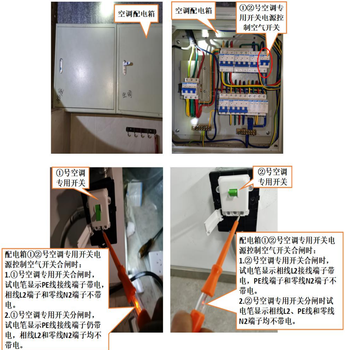
图 11 ①号、②号空调专用开关电源输出端子带电情况勘查
